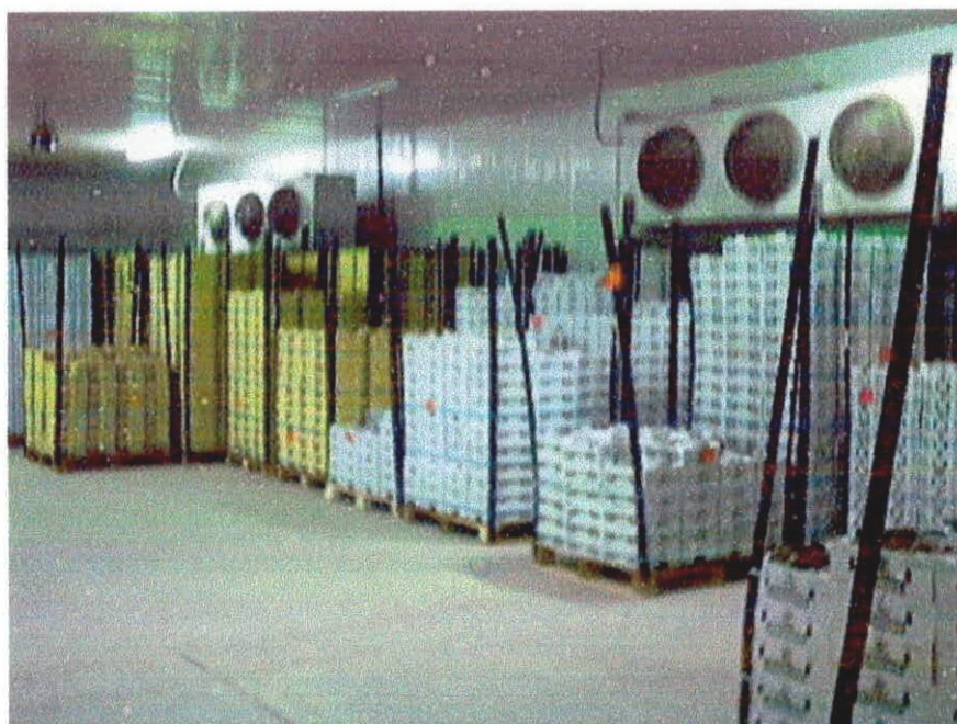
Figura 2. 21 Pallets ubicados en cámara de conservación 2
