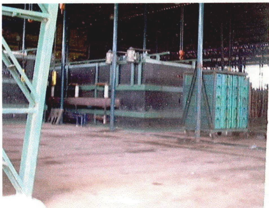
Figura 2. 10 Tanque para tratamiento térmico
