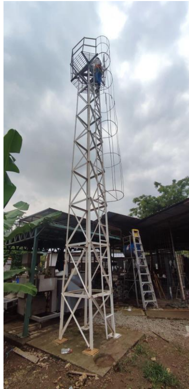
Figura 4. 17 Torre de alojamiento de Turbina Eólica
