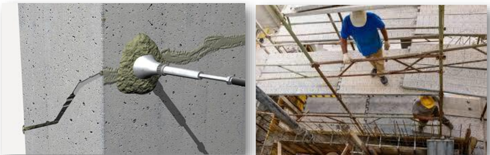
Fisura de hormigón
