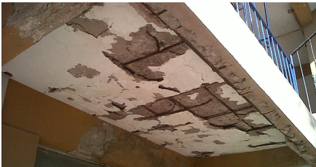
Figura 2-14: Corrosión avanzada en armaduras de concreto reforzado. Fuente: (Desarrollos ESC, 2023).
