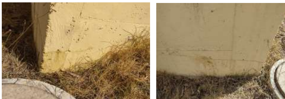
Figura 3.11 Grietas en el costado de la unidad
