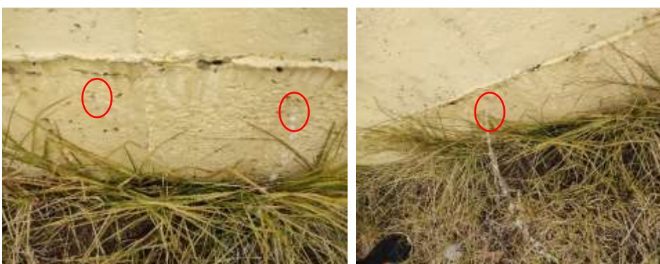
Figura 3.13 Fugas en el filtro biológico
