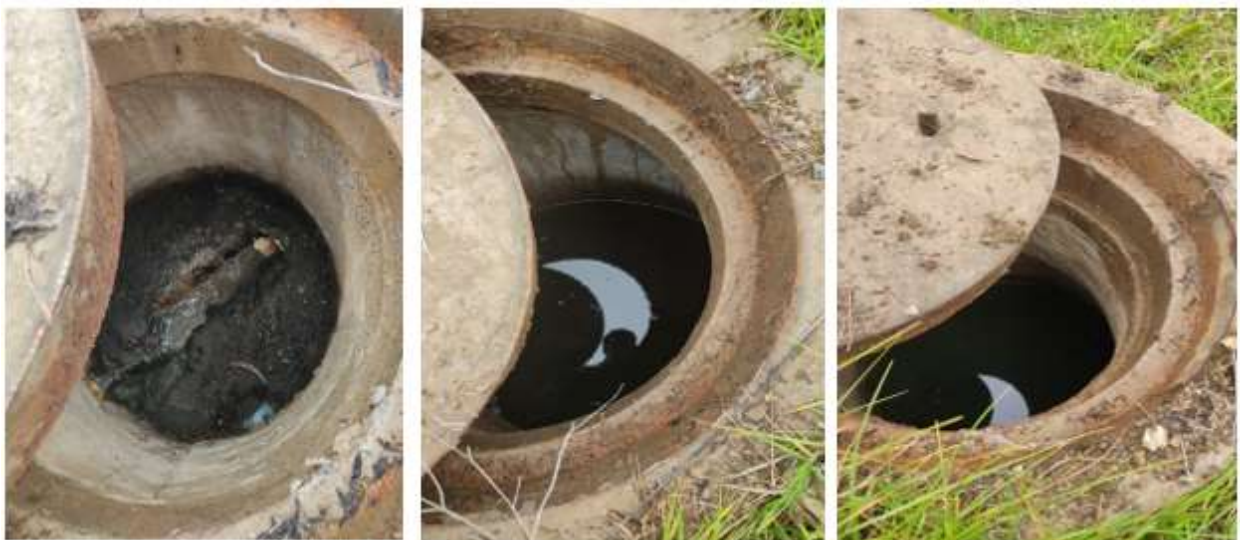
Figura 3.4 Estado de pozos internos
