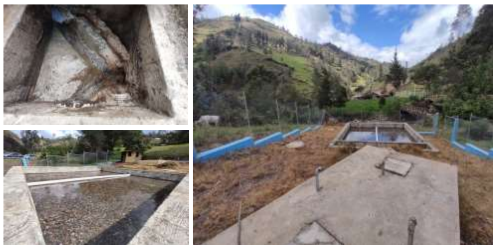
Figura 3.7 Pruebas de funcionamiento de la PTAR
