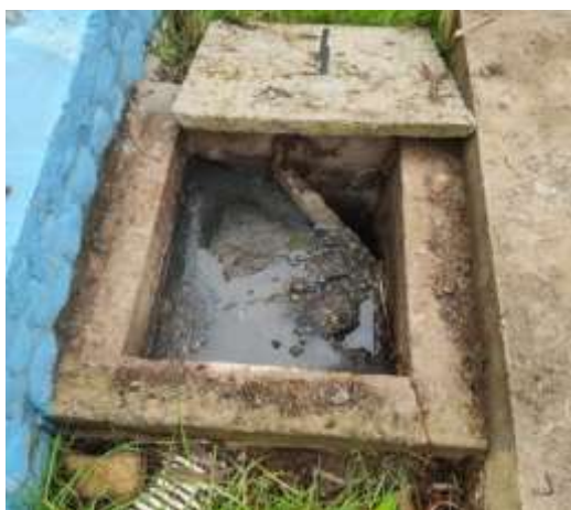
Figura 3.2 Acumulación de sólidos en caja de ingreso
