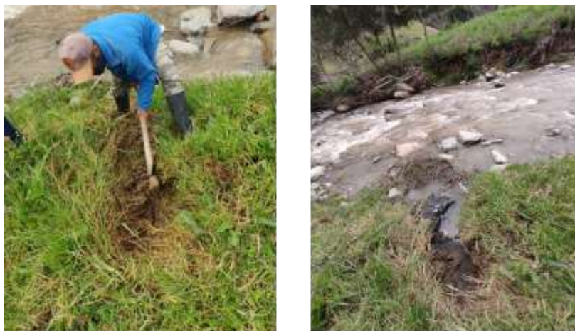
Figura 3.5 Salida de PTAR taponada
