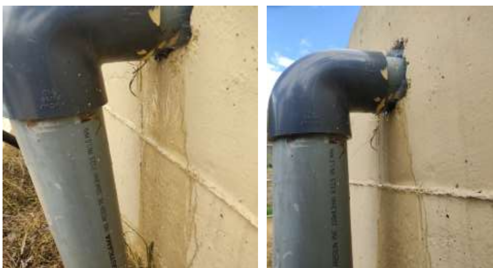
Figura 3.12 Filtraciones en la tubería de salida
