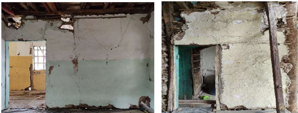
Figura 2.22: Deterioro en muros planta baja
