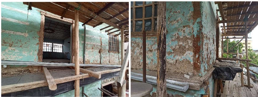
Figura 2.24: Desprendimientos y fisuras
