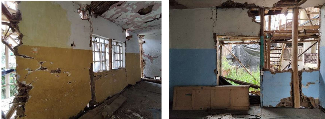
Figura 2.23: Discontinuidad en entramado y diagonales
