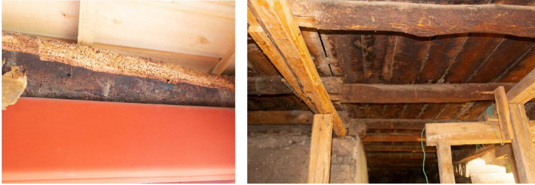
Figura 2.26: Polilla en vigas de madera
