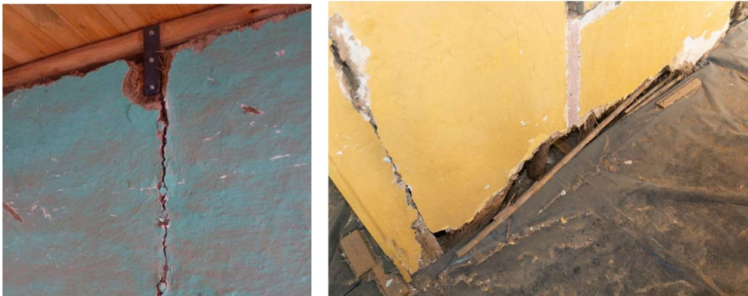
Figura 2.25: Fisuras y grietas
