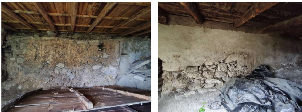
Figura 2.21: Deterioro en muros planta de sótano
