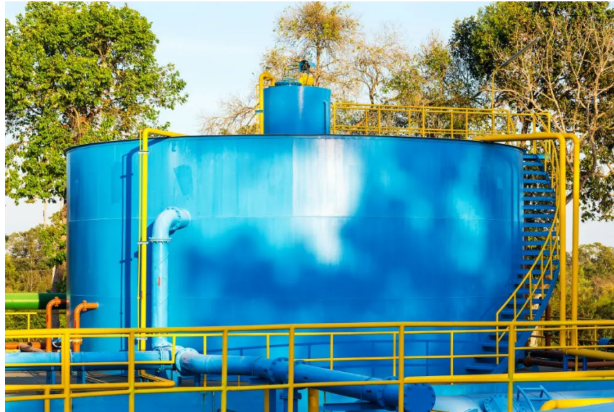
Figura 1.1 Tanque con control de Nivel
