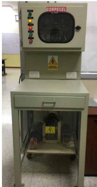
Figura 2.1 Vista Frontal de la Planta
