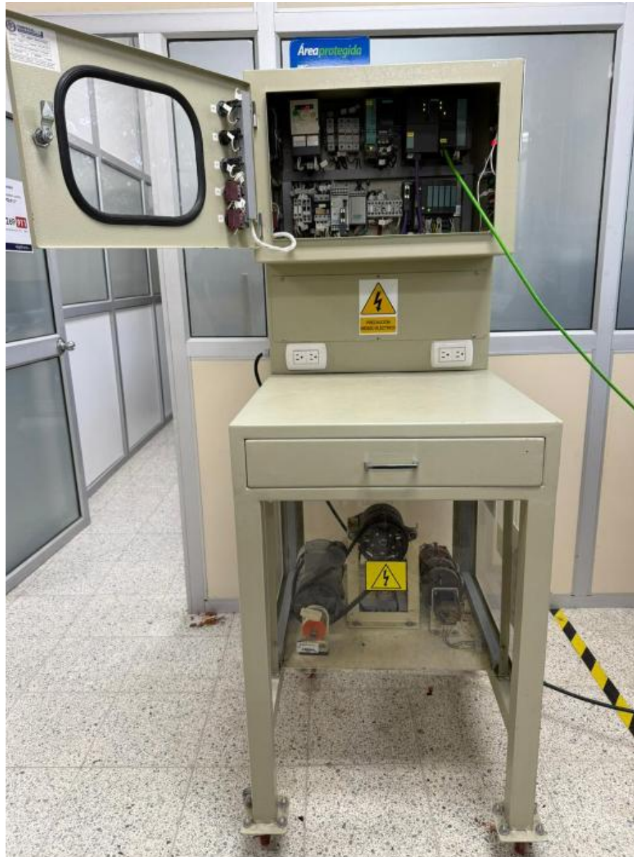
Figura 3.1 Planta de generación eléctrica repotenciada y operativa (puesta en marcha en laboratorio)
