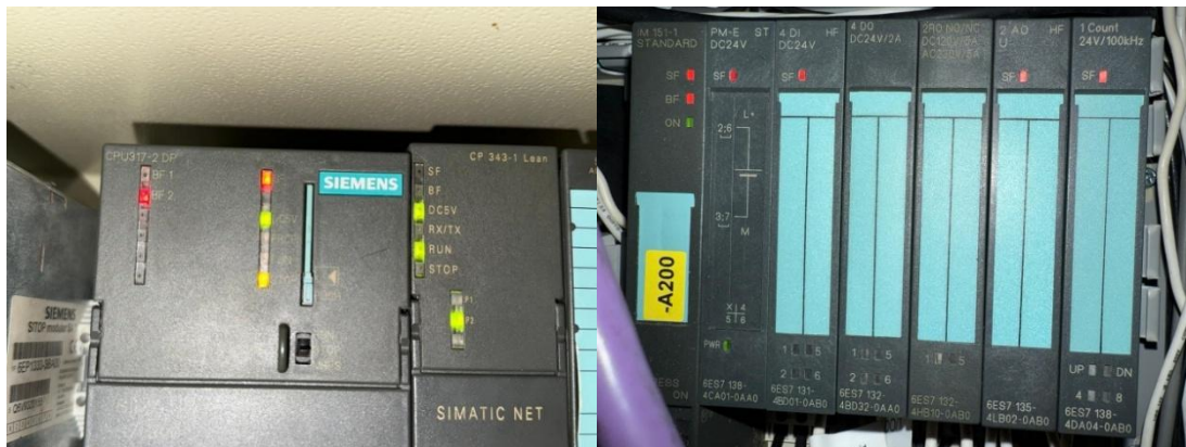
Figura 2.3 Equipos con falla de comunicación
