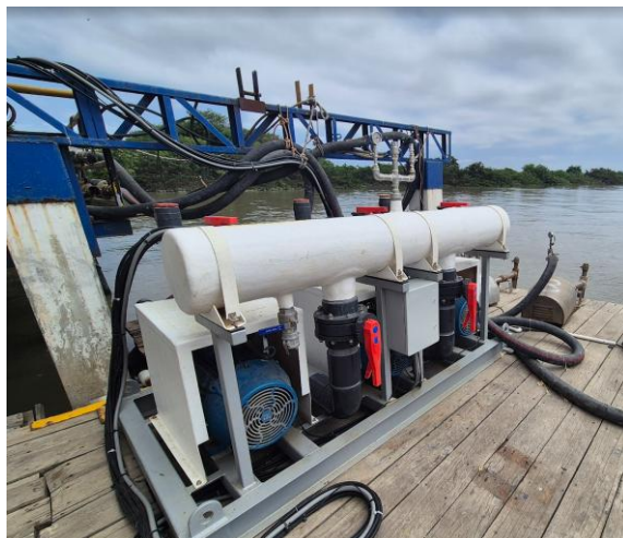
Figura 6: Captación de la PTAP.
