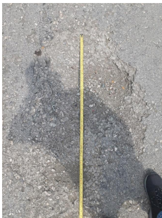
Figura 3.3 Bache de severidad Alta (Abscisa 1+170)
