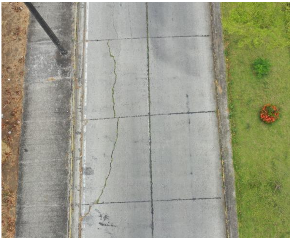
Figura 3.27 Hundimiento de losa 1 cm, foto tomada con dron (Abscisa 1+377)
