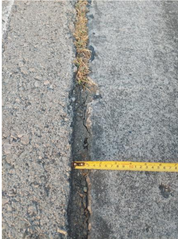
Figura 3.21 Junta longitudinal con ancho anormal (3 cm), carril de ingreso (Abscisa 0+850)
