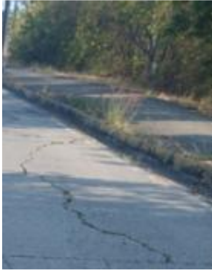
Figura 3.26 Hundimiento de losa 1 cm, carril de salida (Abscisa 1+377)
