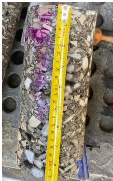
Figura 3.2 Oquedades en el hormigón (abscisa 1+460)
