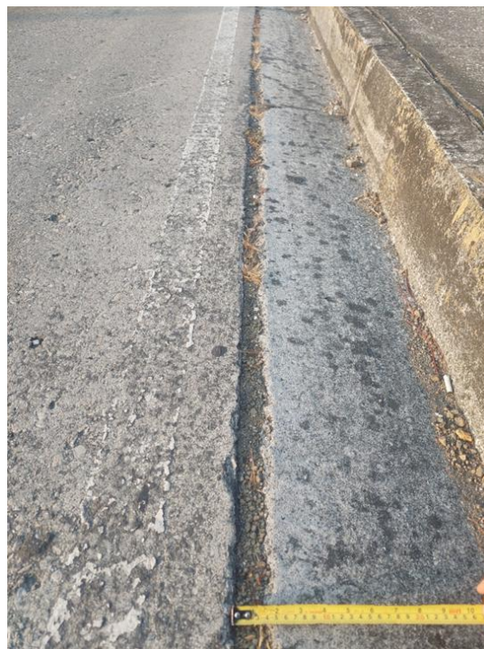
Figura 3.20 Junta longitudinal con ancho anormal (3 cm), carril de ingreso (Abscisa 0+530)
