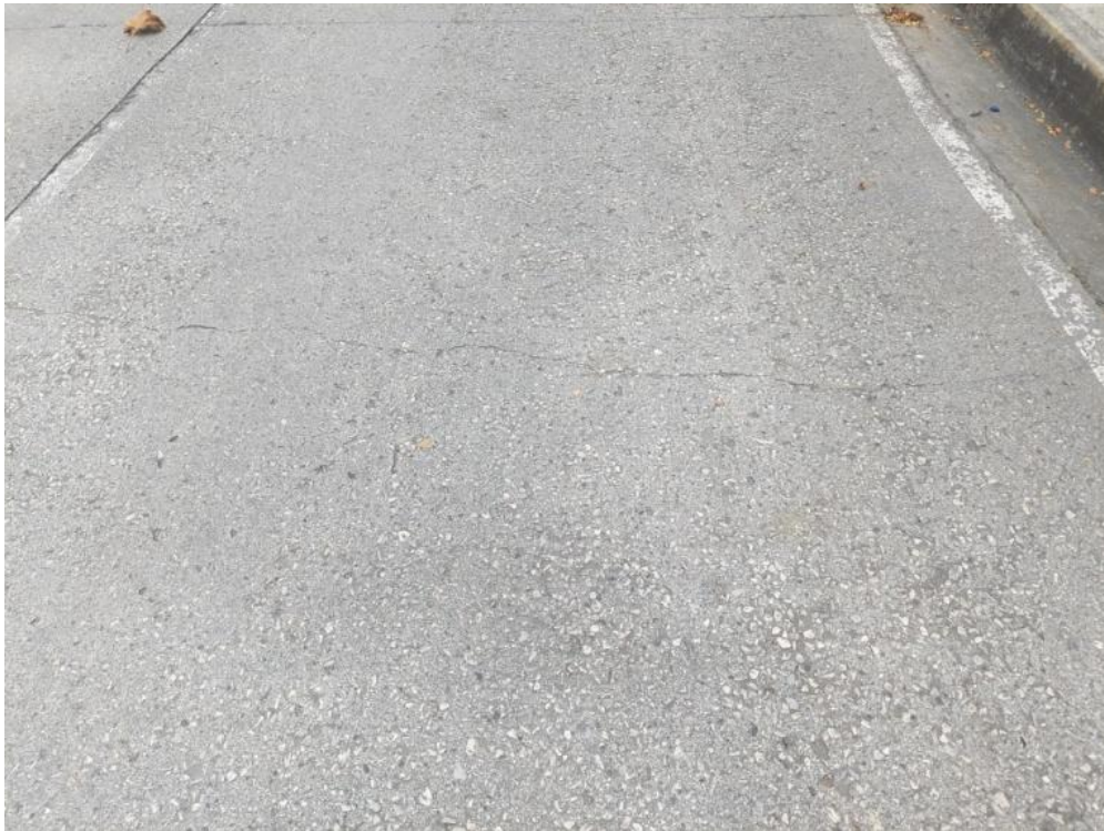
Figura 3.22 Fisura transversal de severidad baja (abscisa 1+163)
