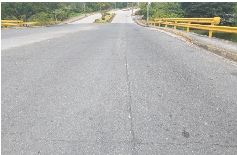
Figura 3.6 Daños superficiales y juntas de la losa reflejados en carpeta asfáltica sobrepuesta (Abscisa 1+040)
