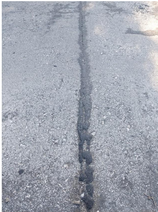
Figura 3.17 Mantenimiento deficiente de material de sello en junta transversal, carril de ingreso (Abscisa 0+085)
