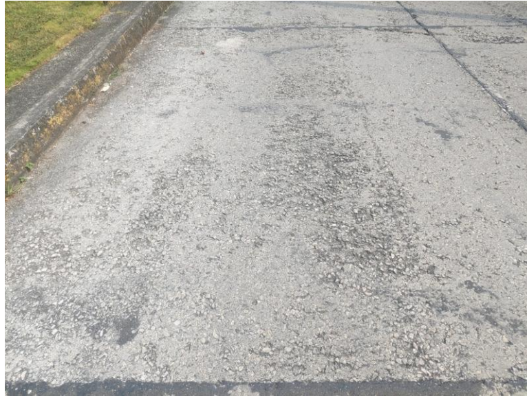
Figura 3.4 Bache de severidad Alta (Abscisa 0+664)
