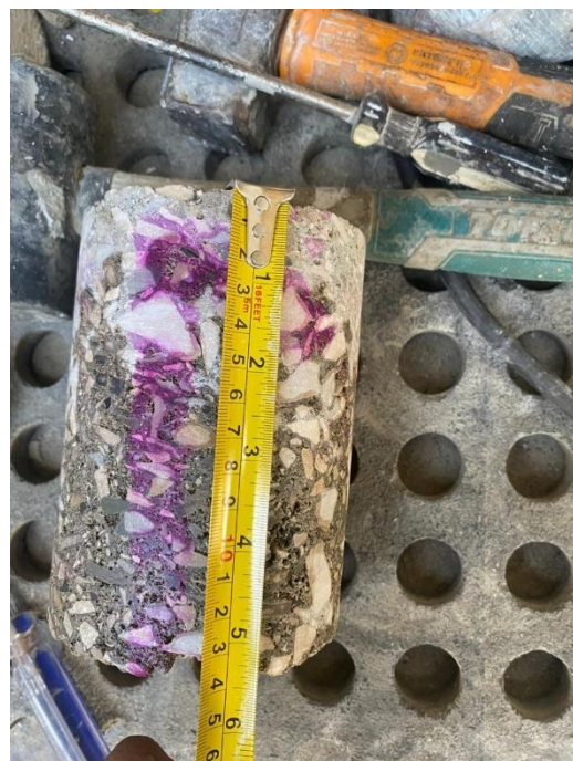
Figura 2.26 Núcleo de hormigón ensayado para Carbonatación (interior de ESPOL, a 70 m del inicio de la vía)
