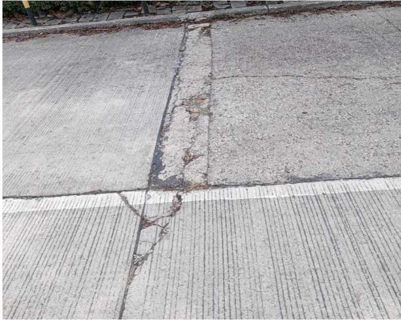
Figura 3.7 Reparación parcial de losa realizada al interior del campus. 1 de 10.
