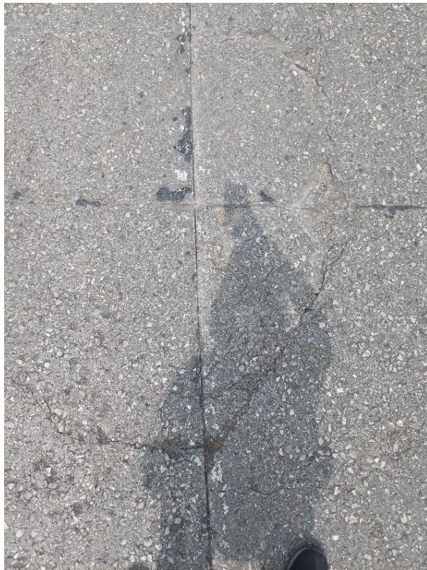
Figura 3.25 Hundimiento de losas 1 cm (Abscisa 1+234)
