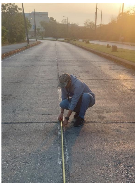
Figura 2.18 Levantamiento de daños en la losa de hormigón.
