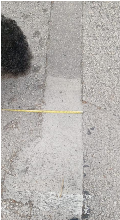
Figura 3.8 Reparación parcial de losa realizada al interior del campus. 2 de 10.
