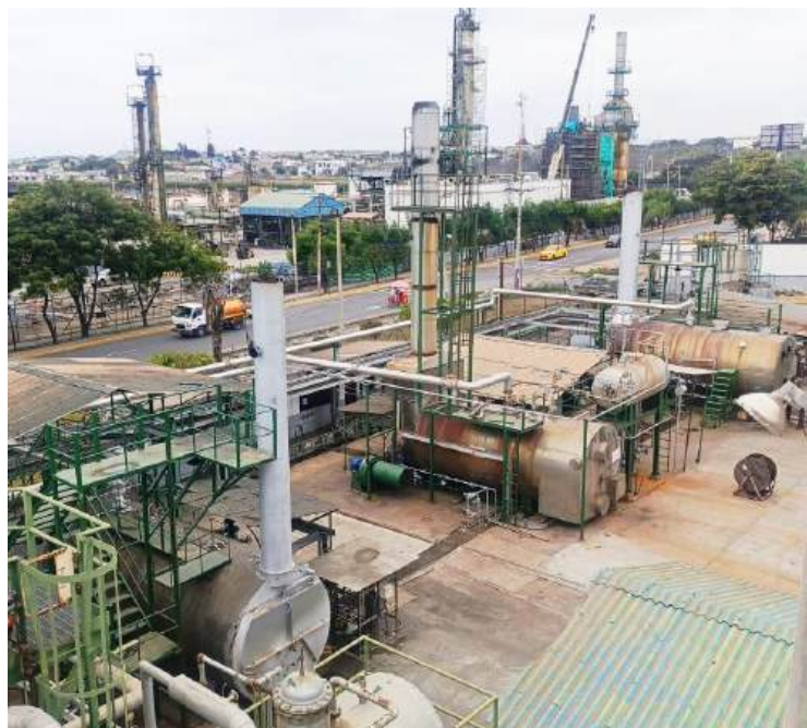
Figura 13 Calderas de generación de vapor de la Refinería La Libertad
