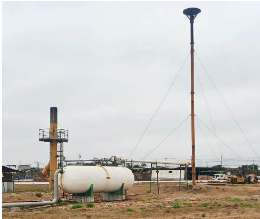
Figura 8 Sistema de quema y purga de gas residual en la Refinería La Libertad
