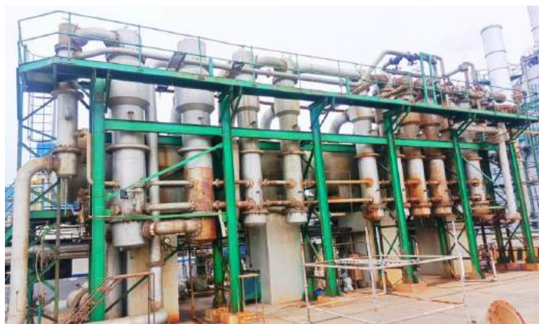
Figura 12 Planta de tratamiento de agua (desalinización) de la Refinería La Libertad
