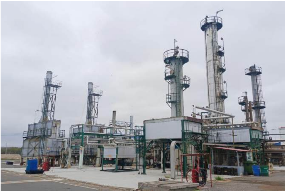
Figura 11 Vista general de la Unidad de Destilación Cautivo de la Refinería La Libertad
