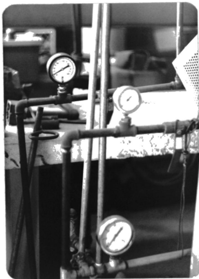
Fig. 2.4.- Controles de Presión del Sistema.
