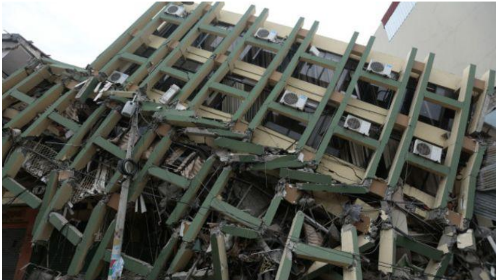
Figura 2.2 Daños estructurales severos en la zona epicentral del terremoto de Ecuador 2016 (BBC News Mundo, 2016)
