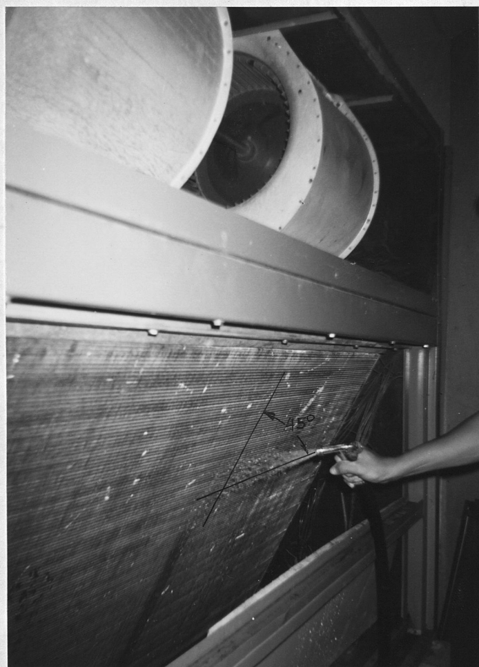
Figura # 14 Angulo correcto de lavado en los serpentines.
