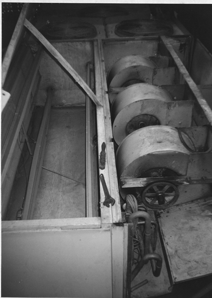
Figura # 5 Estado del aislante, durante un mantenimiento preventivo a equipo de "Mi Comisariato" de Av. de las Américas.
