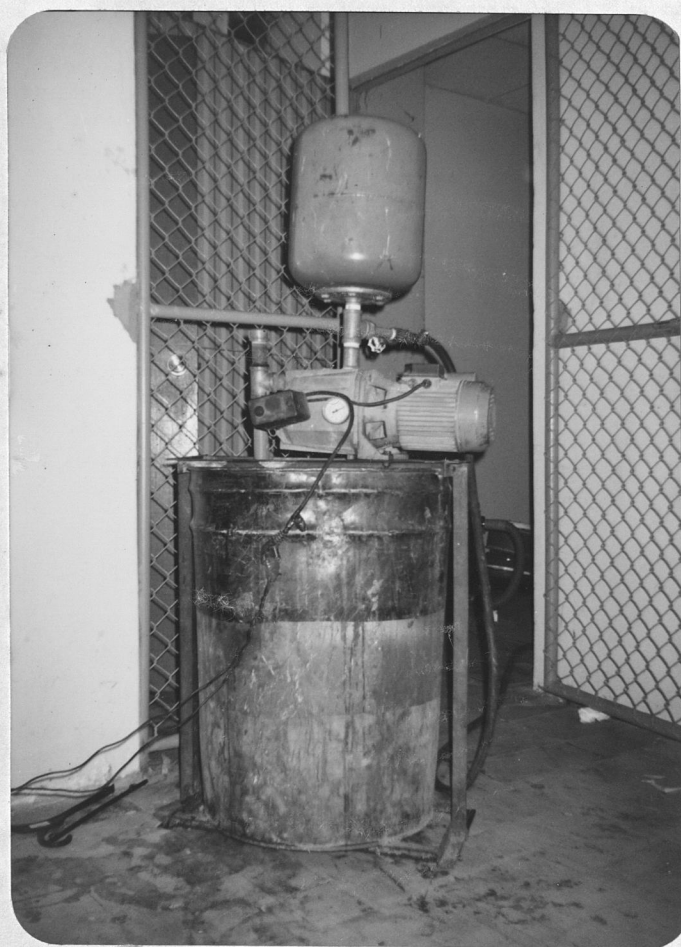
Figura # 15 Reservorio metálico con bomba y tanque de presión incorporados para limpieza de serpentines.
