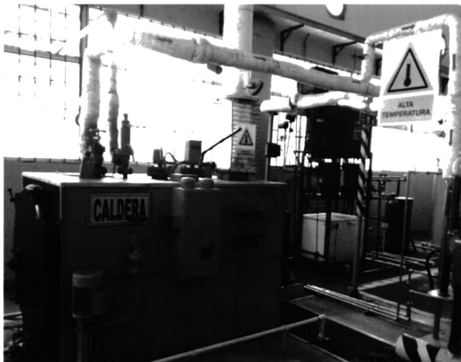
FIGURA 1: CALDERA EN EL LABORATORIO DE TERMOFLUIDOS FIMCP - ESPOL
