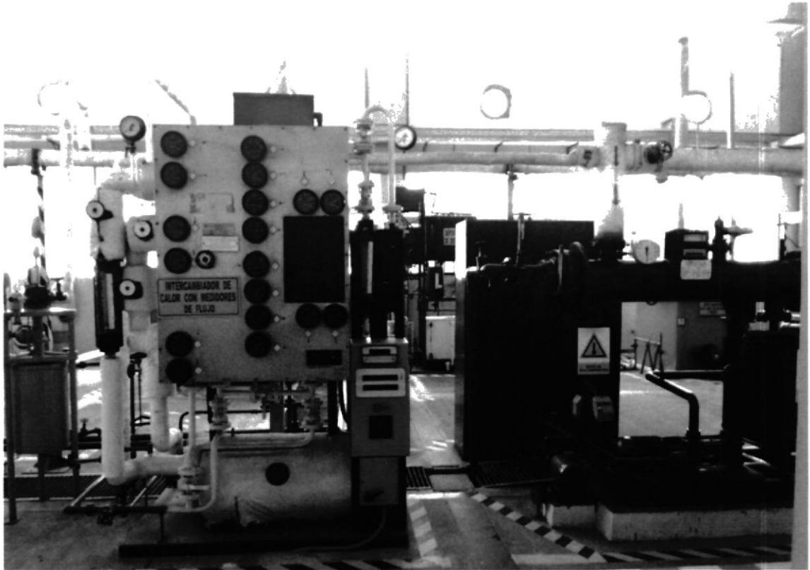
FIGURA 3: INTERCAMBIADOR DE CALOR CON MEDIDORES DE FLUJO- LABORATORIO DE TERMOFLUIDOS FIMCP-ESPOL
