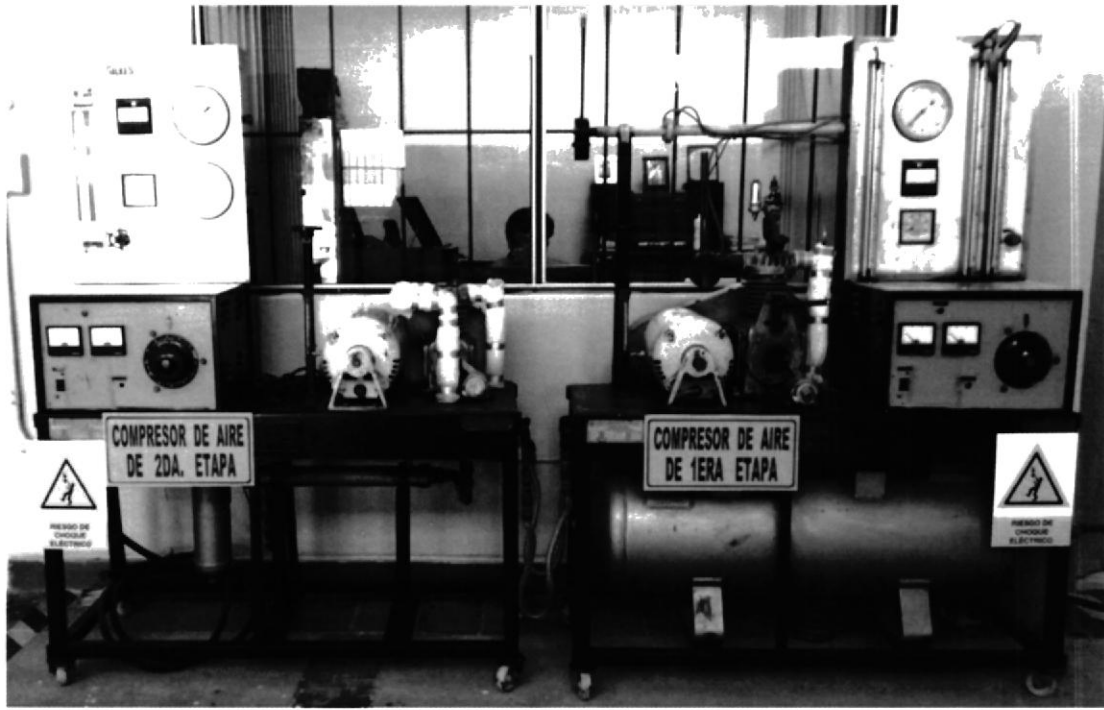
FIGURA 4: COMPRESORES DE AIRE EN EL LABORATORIO DE TERMOFLUIDOS FIMCP - ESPOL
