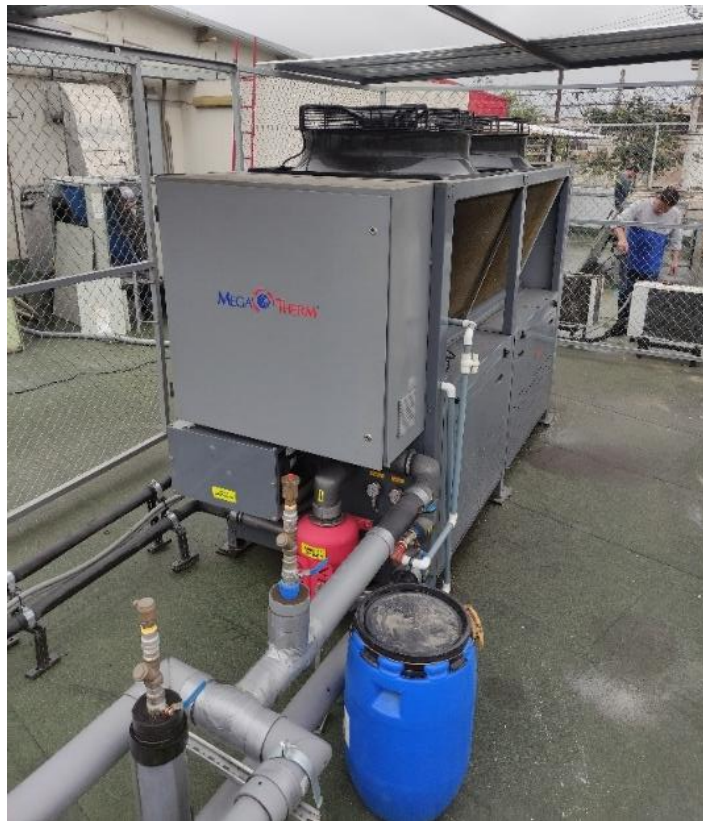
Figura 51 Unidad de compresores para sistemas de media y baja temperatura.
