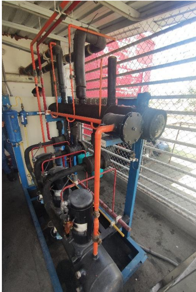
Figura 16 Antigo rack de compresores de media temperatura.
