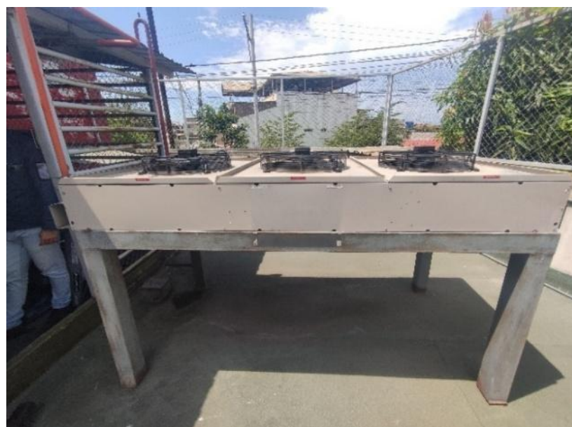
Figura 17 Antigo condensadora de media temperatura.
