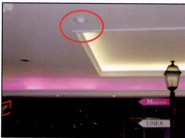
Figura 5 Antena tipo omni instalada en el corredor de un centro comercial
