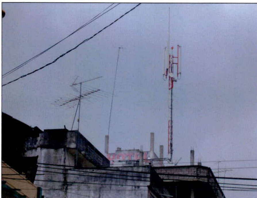
Figura 4 Radiobase tipo terraza con torreta ventada
