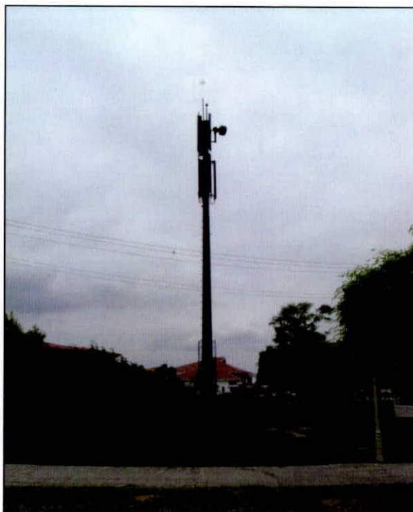
Figura 3 Radiobase tipo terreno con monopolo
