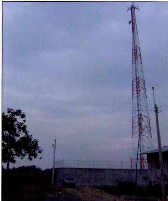
Figura 2 Radiobase tipo terreno con torre autosoportada
