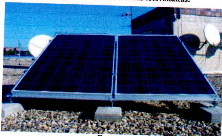
Figura 18. Panel de celdas fotovoltaicas.
