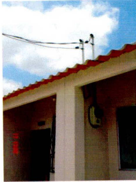
Foto 7.- Acometida de Energía Eléctrica
