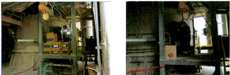
Proceso de incineración de residuos
