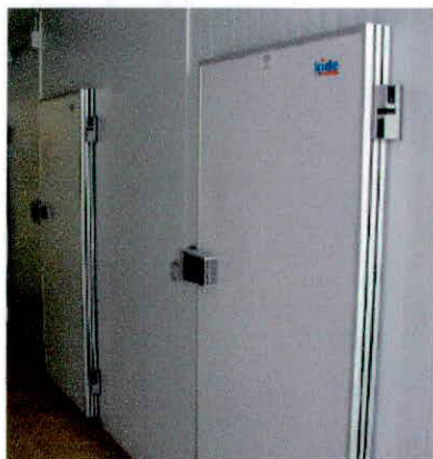
FIGURA 2.2: CAMARA DE REFRIGERACION
