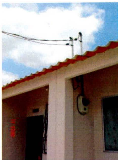
Foto 7.- Acometida de Energía Eléctrica
