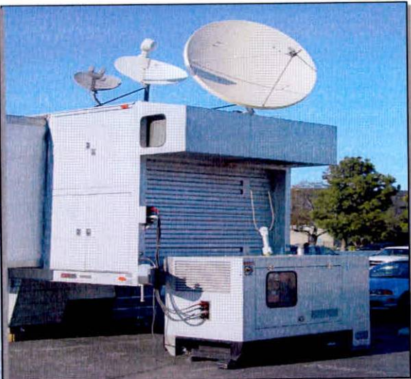
Área de Generador
