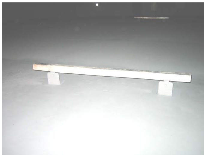
FIGURA 3.4 UBICACION FINAL DE LOS ANODOS GALVALUM III AL INTERIOR DEL TANQUE
