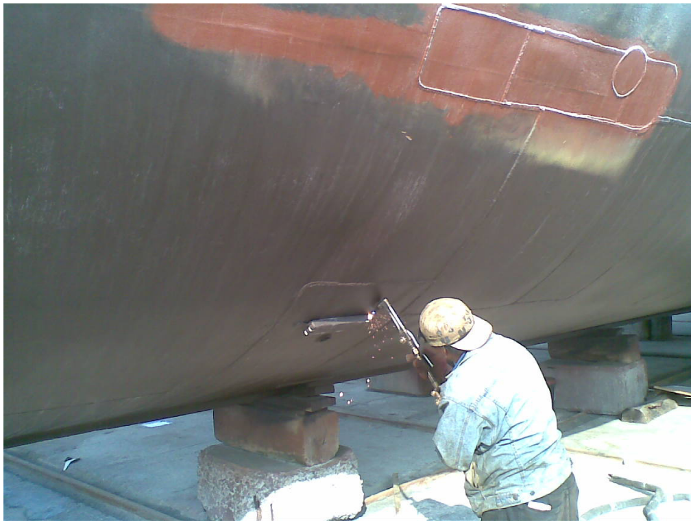
Figura 7.- Corte de un ánodo de zinc
