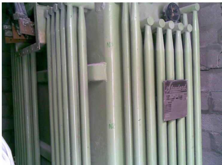
Figura #13 Transformador de la subestación “Planta de Cal”
