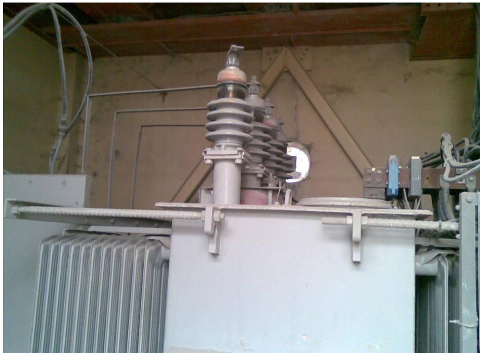
Figura #8 Transformador de la subestación “Trituración Secundaria”
