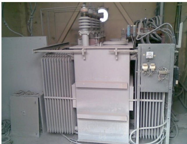
Figura #23 Transformador de Potencia de la subestación "Trit. Secundaria"
