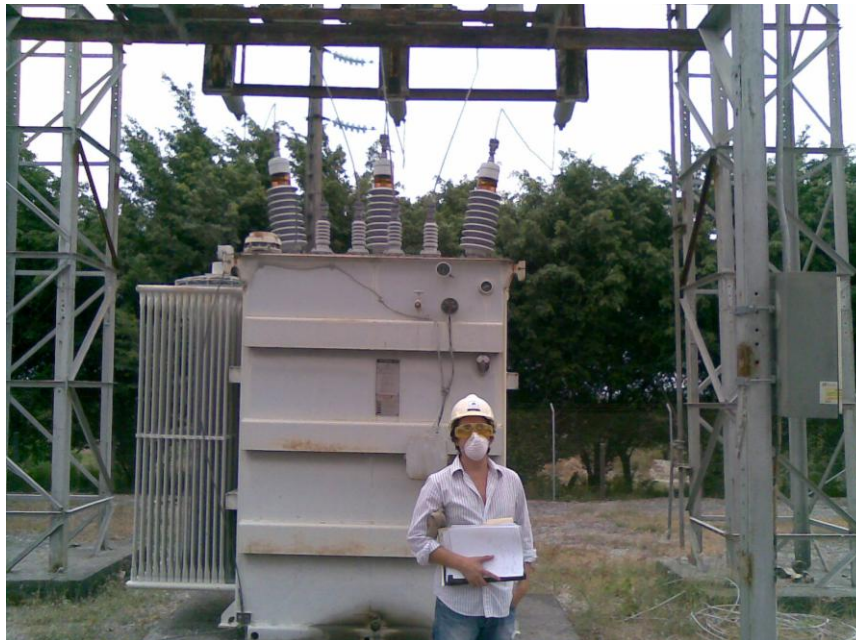
Figura #21 Transformador de Potencia de la subestación Principal
