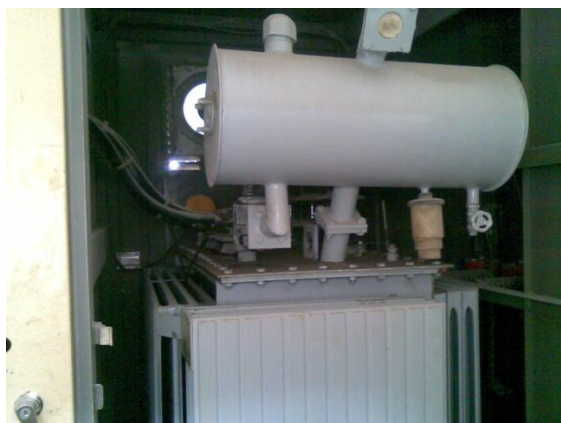
Figura #5 Transformador de la subestación "Trituración Primaria"
