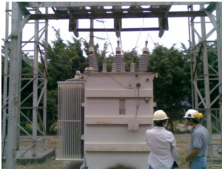
Figura #3. Subestación principal
