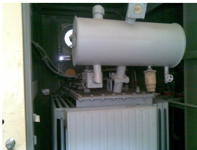
Figura #22 Transformador de Potencia de la subestación "Trituración primaria"
