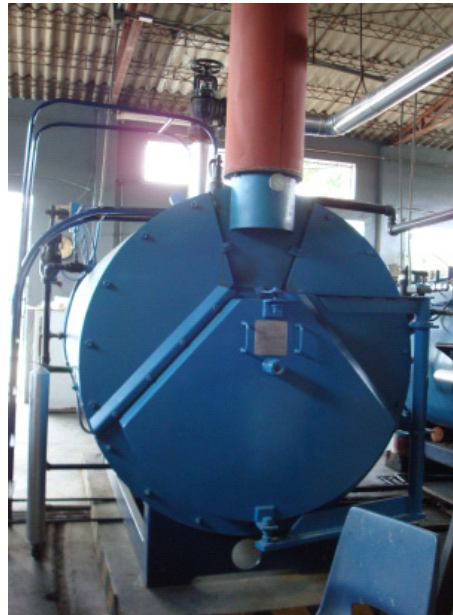
Fig. 1.3 Área de Calderos
