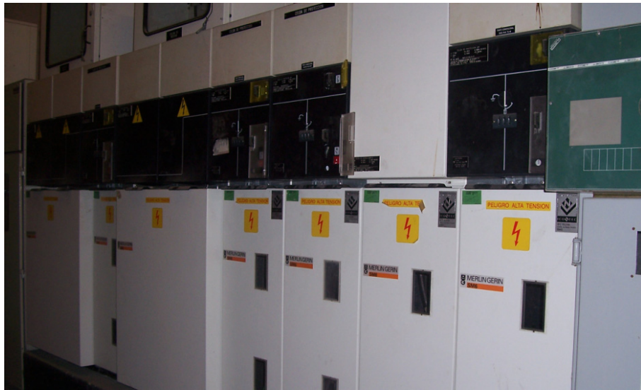
Conjunto de celdas con Seccionador Fusible.
