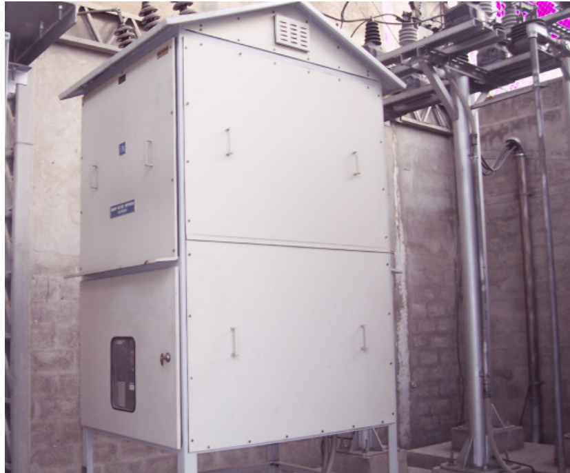
Interruptor a nivel de 13.8 KV.
