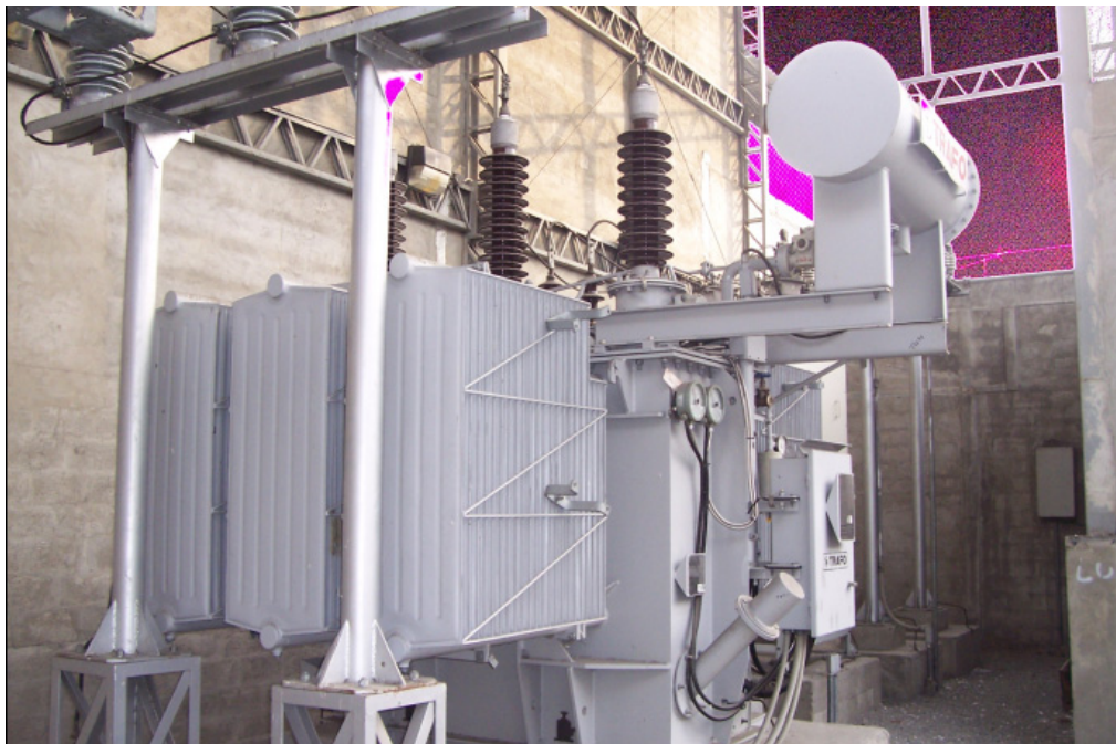
Transformador de poder 69/13.8 KV
