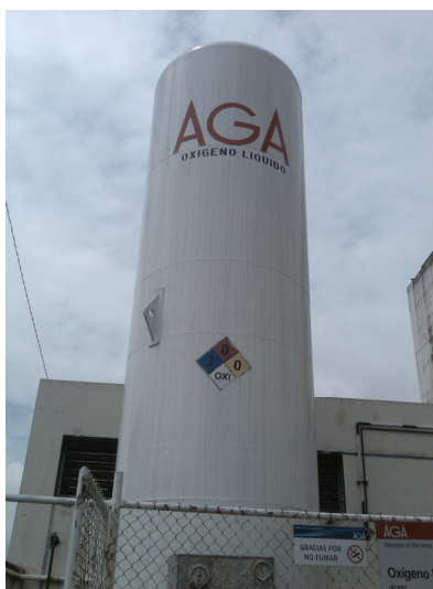
Fig. 1.20 Tanque de oxígeno líquido.
