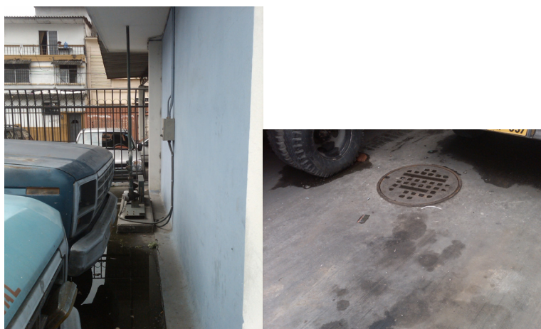
Fig.1.22 Almacenamiento y control del diesel.
