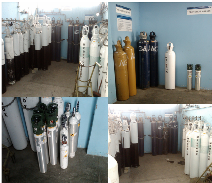
Fig.1.18 Interiores de la central de gases medicinales.
