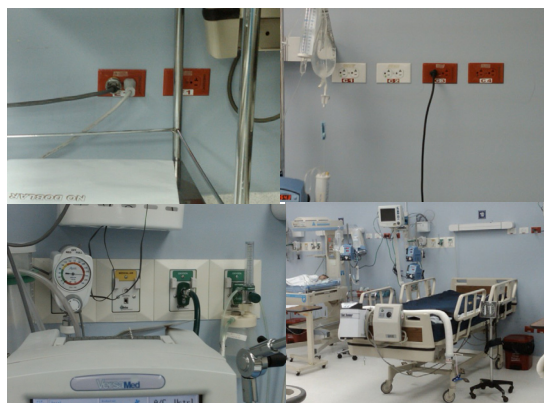
Fig. 4.2 Vistas de los tomacorrientes y tomas de vacío, aire y oxígeno.
