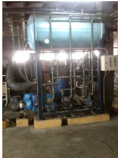
Fig. 2.3 Tanque de condensado.
