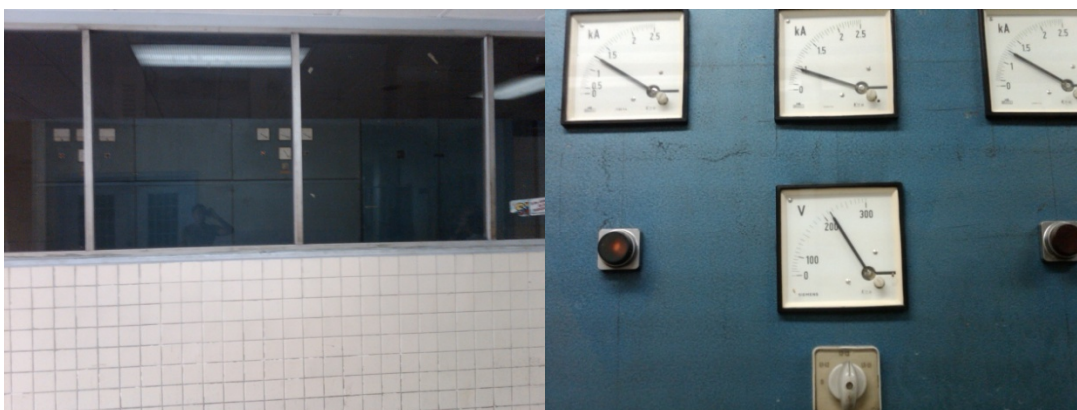
Fig. 2.5 Tableros de distribución.
