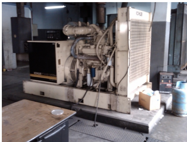
Fig. 2.4 Generador de emergencia.
