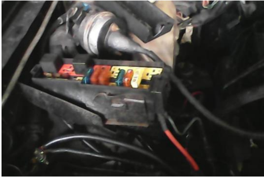
Figura 4. Centro de distribución de potencia
