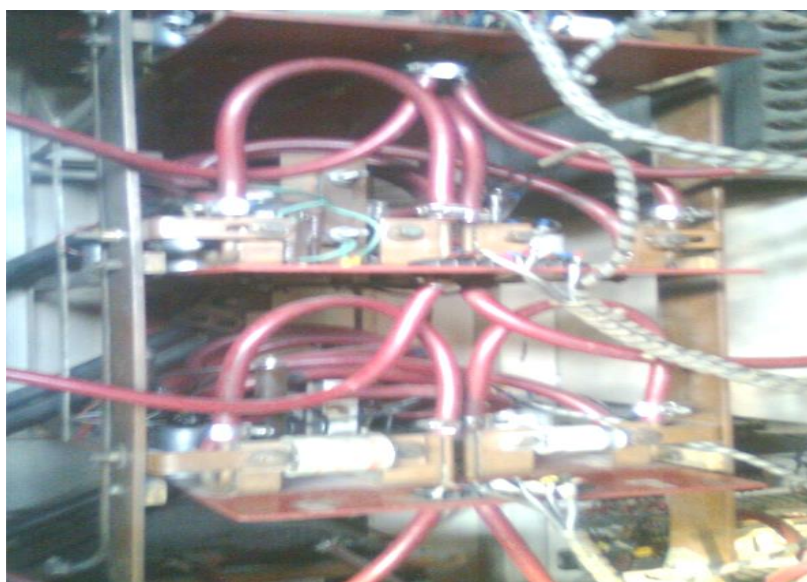
Figura 1.14: Foto de placas de los módulos de SCR
