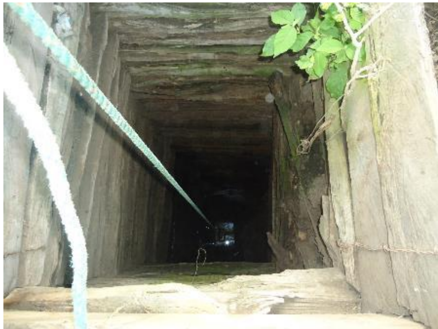
Figura 3.14. Vista interior de un pozo, con paredes cubiertas con tablonces para evitar derrumbes y taponamientos. Fuente: Chancay, J., 2014.
