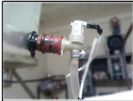
Figura 3. 3: Electroválvula del sistema de potabilización.
