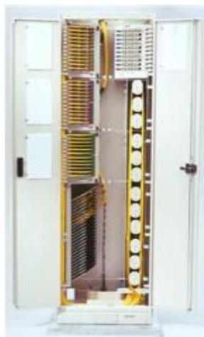
Figura 3.12 Equipo ODF de la marca TYCO [27]
