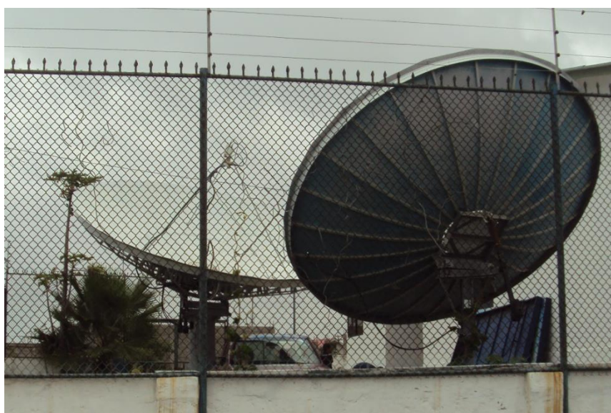
Figura 2.4 Antenas Satelitales localizadas en las instalaciones de ESPOL TV
