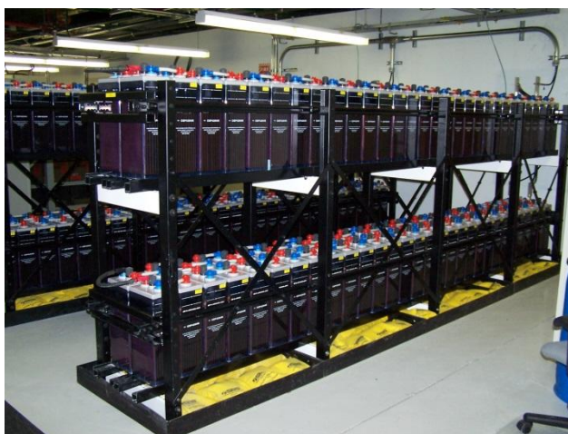
Figura 2.24. Banco de Baterías/generador
