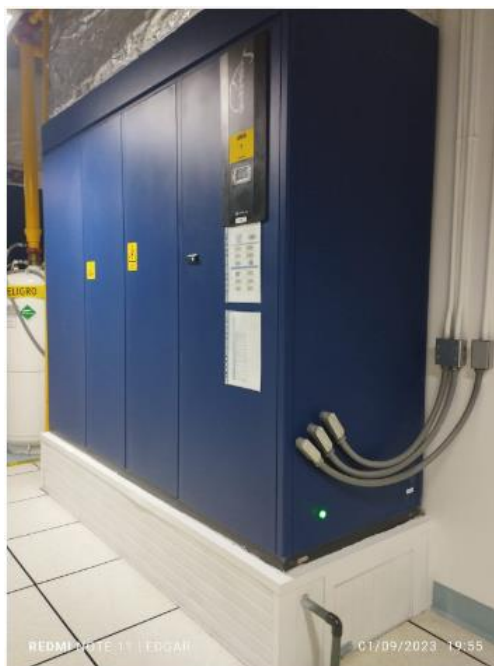
Figura 1.5 Unidad Manejadora de Aire por Agua
