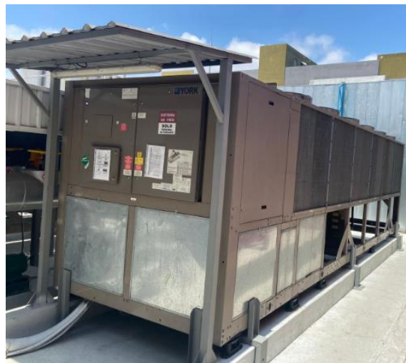
Figura 1.4 Enfriador de Agua
