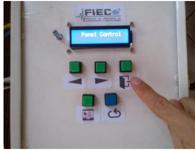
Figura 4.18 Botonera del panel de control para el cierre de la puerta.
