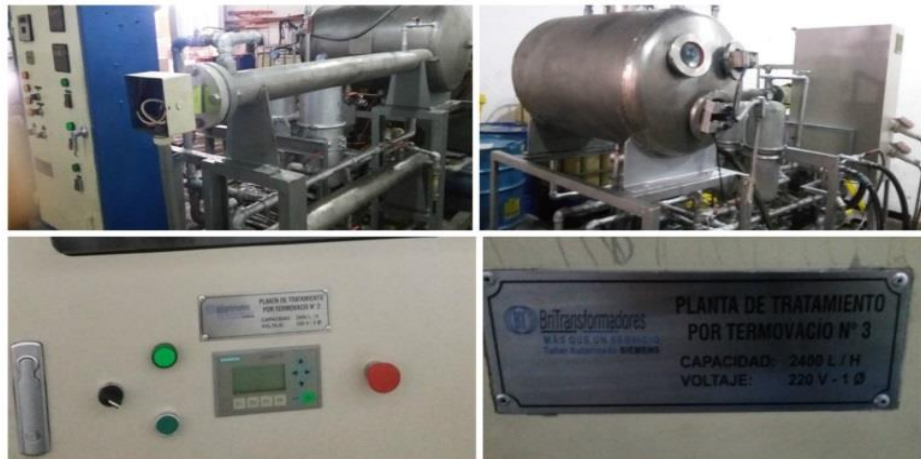
Figura 1.5: Máquina de filtrado 2400 L/N
