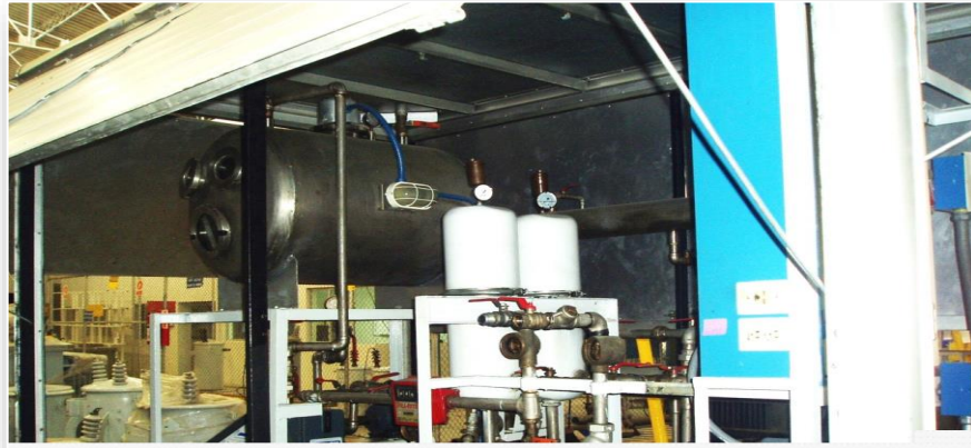
Figura 1.6: Máquina de filtrado 9400 L/N
