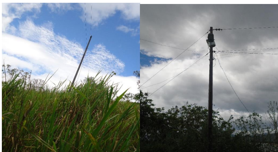
Figura 4.23 Tendido eléctrico existente en cerro Tacuri.
