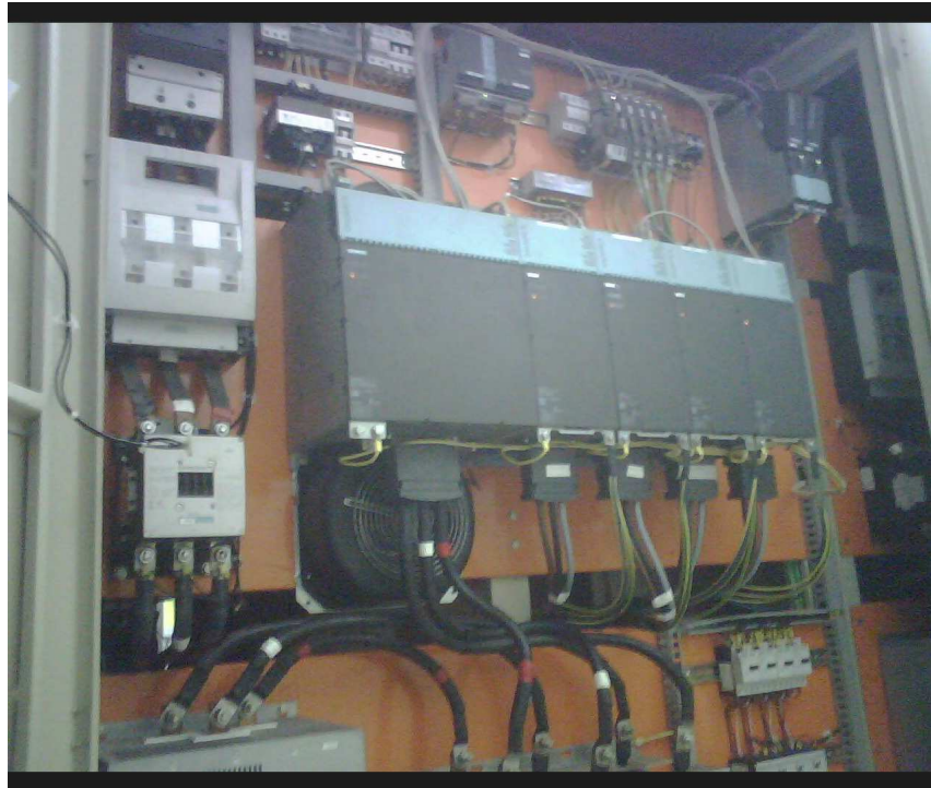
Figura 7: Tablero Grupo #1 de Secadores
