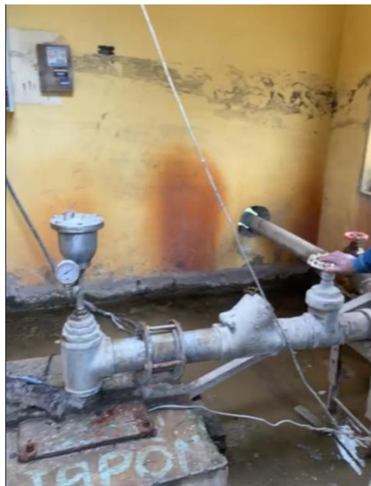
Ilustración 3-2. Equipo de Bombeo para captación de pozo
