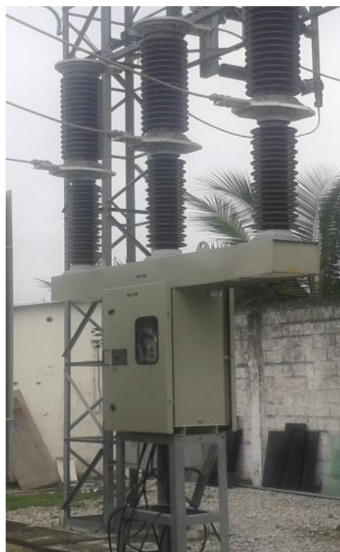
Figura 1.7 Interruptor en Gas SF6
