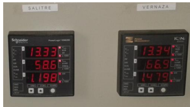
Figura 1.13 Medidores Schneider en la S/E Juan Bautista Aguirre
