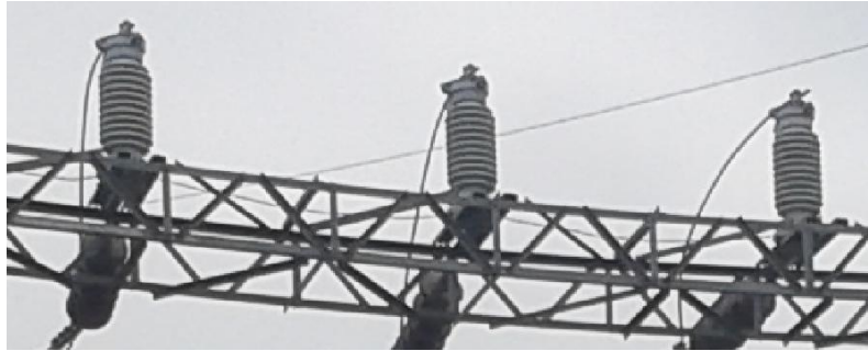
Figura 1.8 Pararrayos en estructura 69KV
