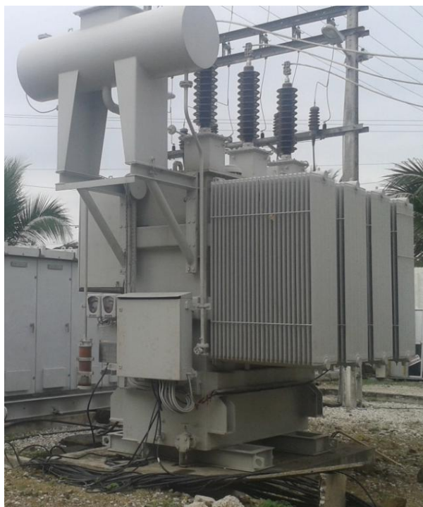
Figura 1.9 Transformador de potencia 69000/13800 V, marca PAUWELS
