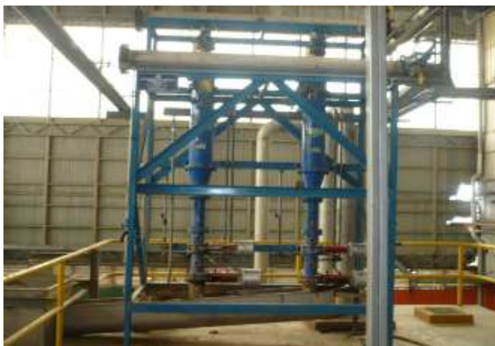
FIGURA 1.14 ESTACIÓN DE LIMPIADORES DE ALTA DENSIDAD DEL MOLINO Nº 2
