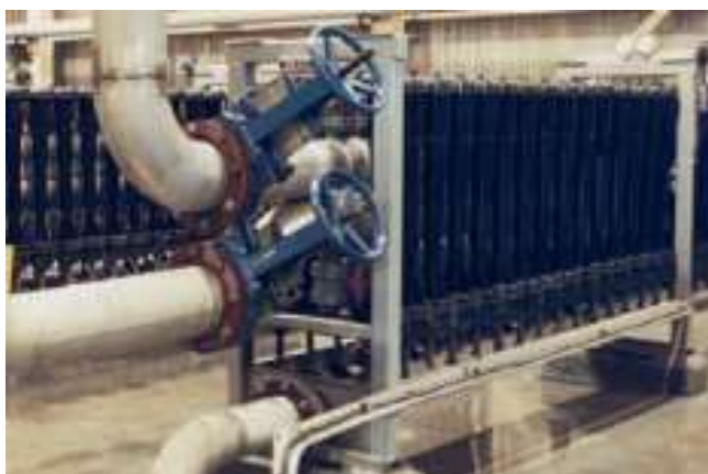
FIGURA 2.7 BANCO DE LIMPIADORES UNIFLOW
