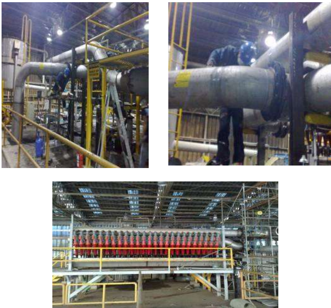
FIGURA. 2.16 ETAPA CONSTRUCTIVA DE LA AMPLIACIÓN DEL SISTEMA DE DEPURACIÓN FINA DE LA PLANTA
