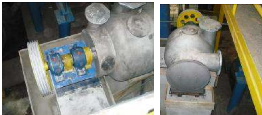
FIGURA 2.14 SISTEMA DESCONTAMINADOR COLOCADO SOBRE SU CIMENTACIÓN.
