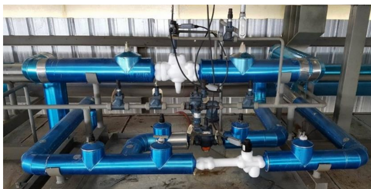
Figura 2.12 Tuberías de amoníaco
