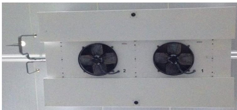
Figura 2.8 Evaporador en techo
