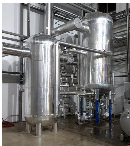
Figura 2.4 Tanque 1 y tanque 2
