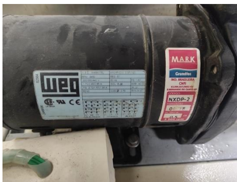
Figura 2.2 Motor eléctrico de la planta de control de caudal.
