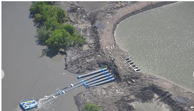
Figura 1.3 Conductos de los suministros de agua
