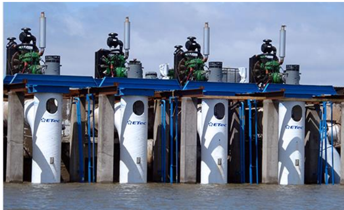
Figura 1.2 Bombas de extracción dentro de las piscinas camarones.
