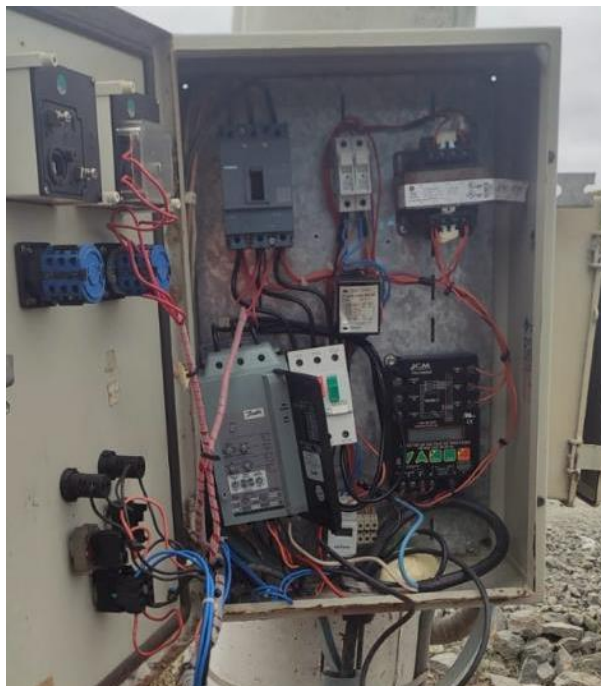
Figura 3.1 Tablero de Control Antes
