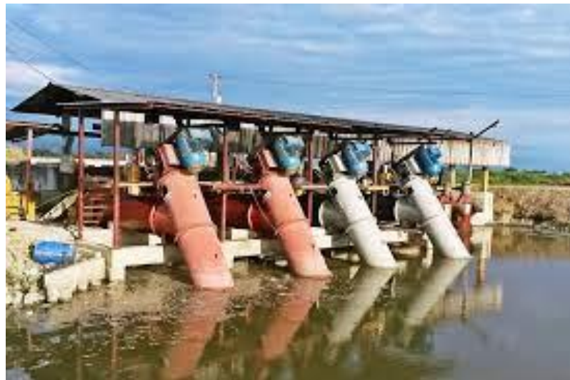
Figura 1.5 Sistema de Bombeo
