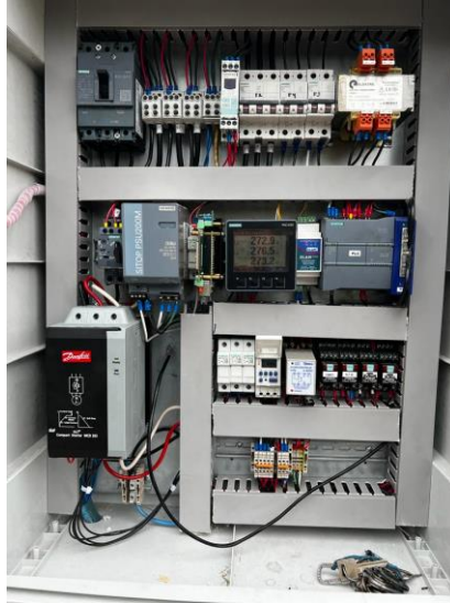
Figura 3.2 Implementación del tablero (Parte interior)
