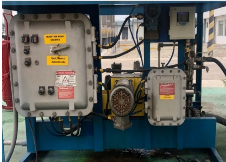
Figura 1.2. Equipos para la inyección del químico. Vista frontal
