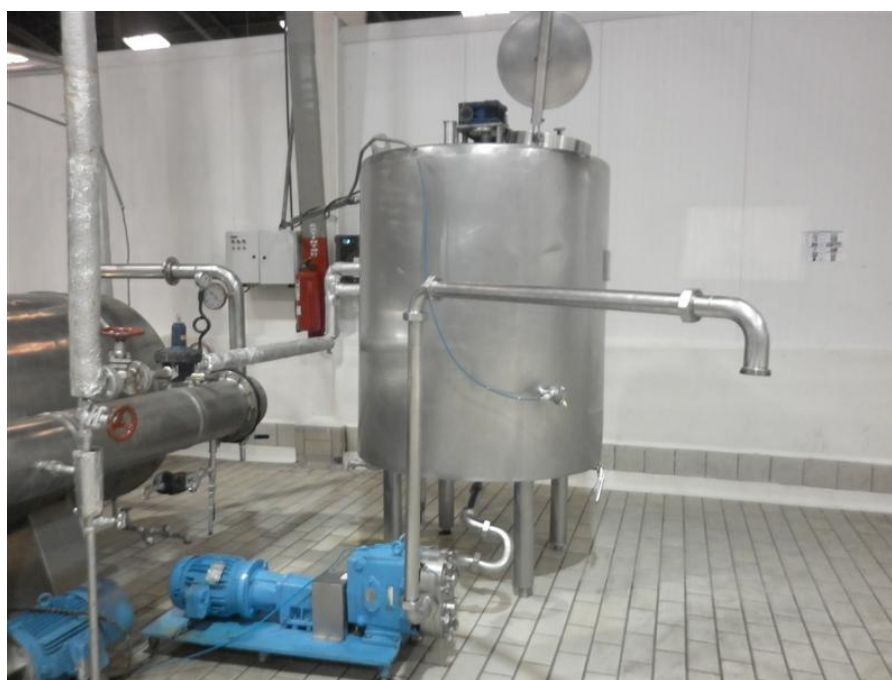
Figura 3.8: Tanque Enchaquetado Instalado en Planta.
