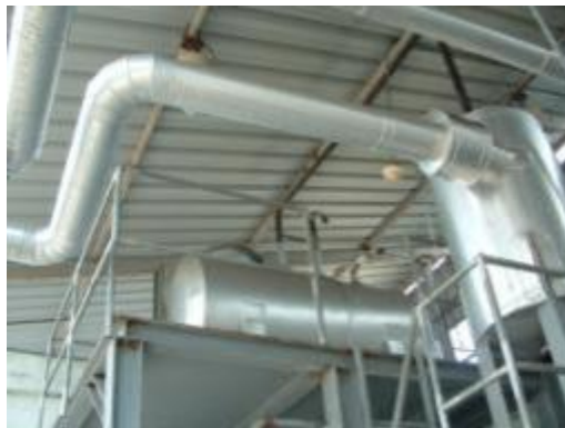
Tanque de Expansión
