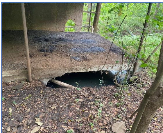
Figura 2.21 Tubería de ingreso pozo séptico E [Elaboración propia, 2023].
