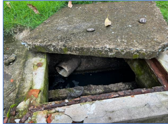
Figura 2.12 Tubería de ingreso pozo séptico B [Elaboración propia, 2023].
