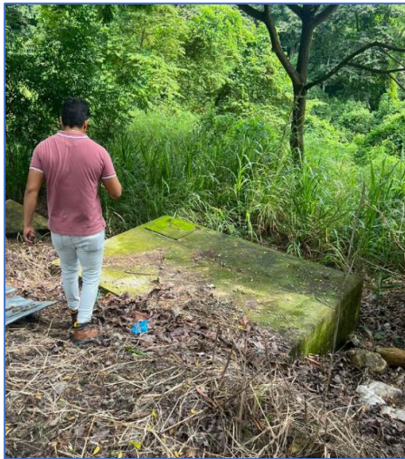
Figura 2.15 Pozo séptico D [Elaboración propia, 2023].
