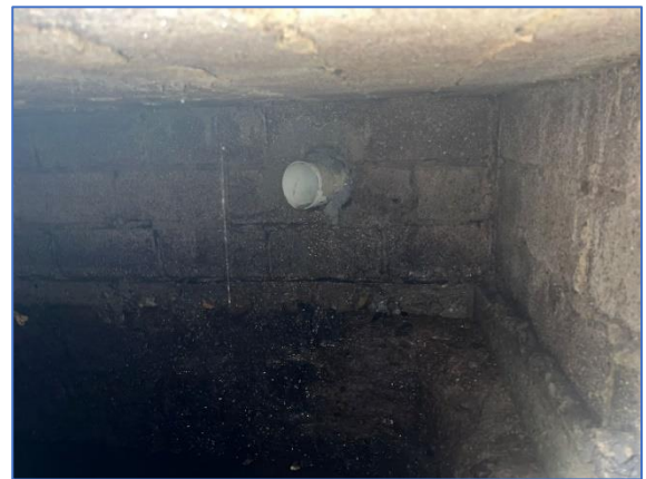
Figura 2.16 Tubería de ingreso al pozo séptico D [Elaboración propia, 2023].
