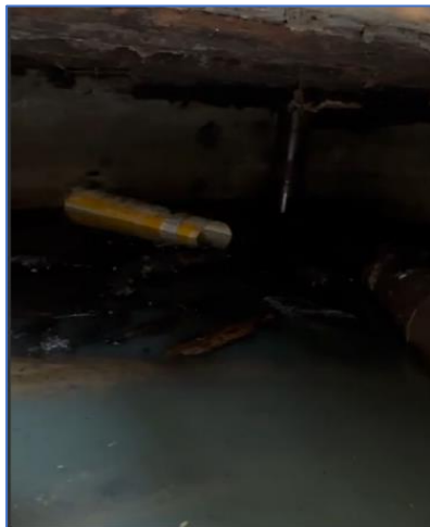
Figura 2.13 Tubería de ingreso al pozo séptico C [Elaboración propia, 2023].
